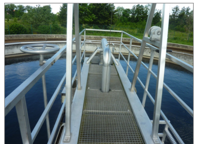
Blick in die Biologische Abwasserreinigung
