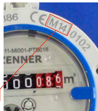
Bei Ringkolbenzählern wird hier das Eichjahr deutlich
