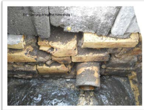
Beispiele für dringend sanierungsbedürftige Anlagen:
