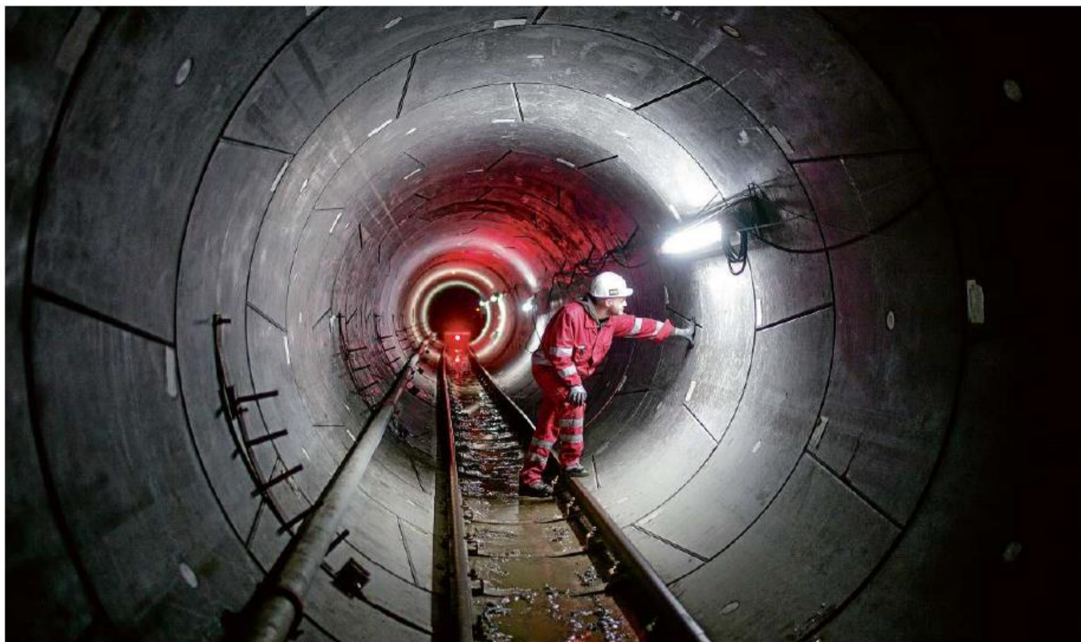
Kanäle transportieren das Abwasser zu den Kläranlagen. Entstörteams müssen verstopfte Abwasserpumpen in Gang setzen.
